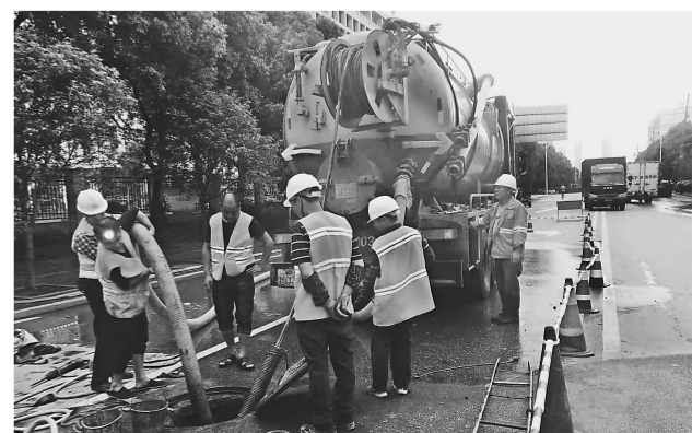
连日来,南昌市青云谱区政府园林养护中心集中对辖区116条道路排水设施进行清掏疏浚,全力推进雨污分流管网建设改造。通讯员 陶畅云摄
