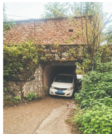
涵洞上方被村民砌了围墙占用。
