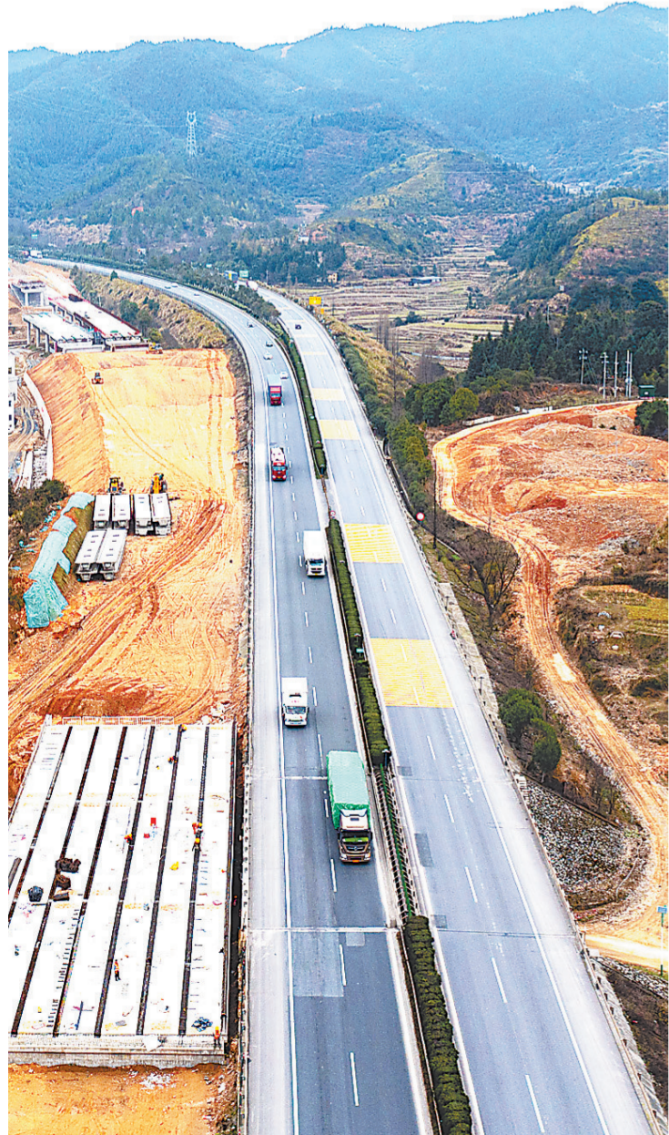
2月26日,在位于遂川县中石乡的大广高速公路吉安至南康段改扩建工程工地,工人们正在紧张施工。据悉,该工程路线全长约145.4公里,是我省规划“10纵10横21联”高速公路网重要的南北向通道。
