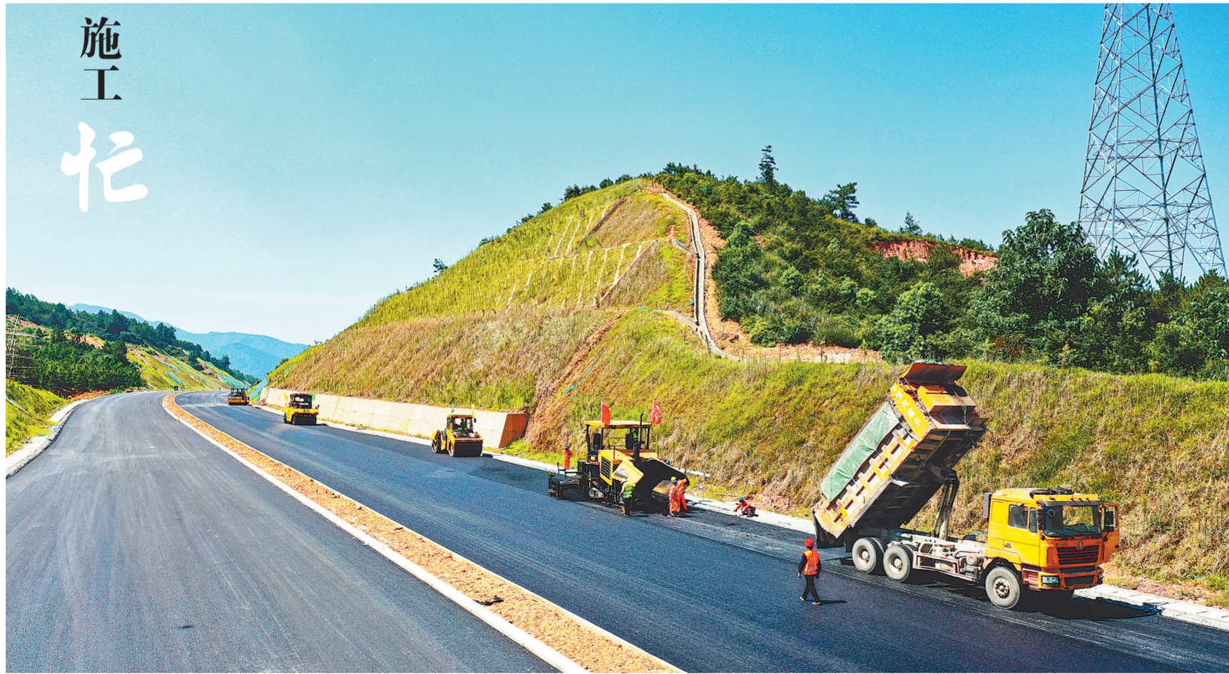
7月12日,吉水县105国道东改项目施工现场,在做好防暑降温工作的同时,工程施工人员正浇筑沥青路面,确保工程按期完工。 特约通讯员 廖敏摄
