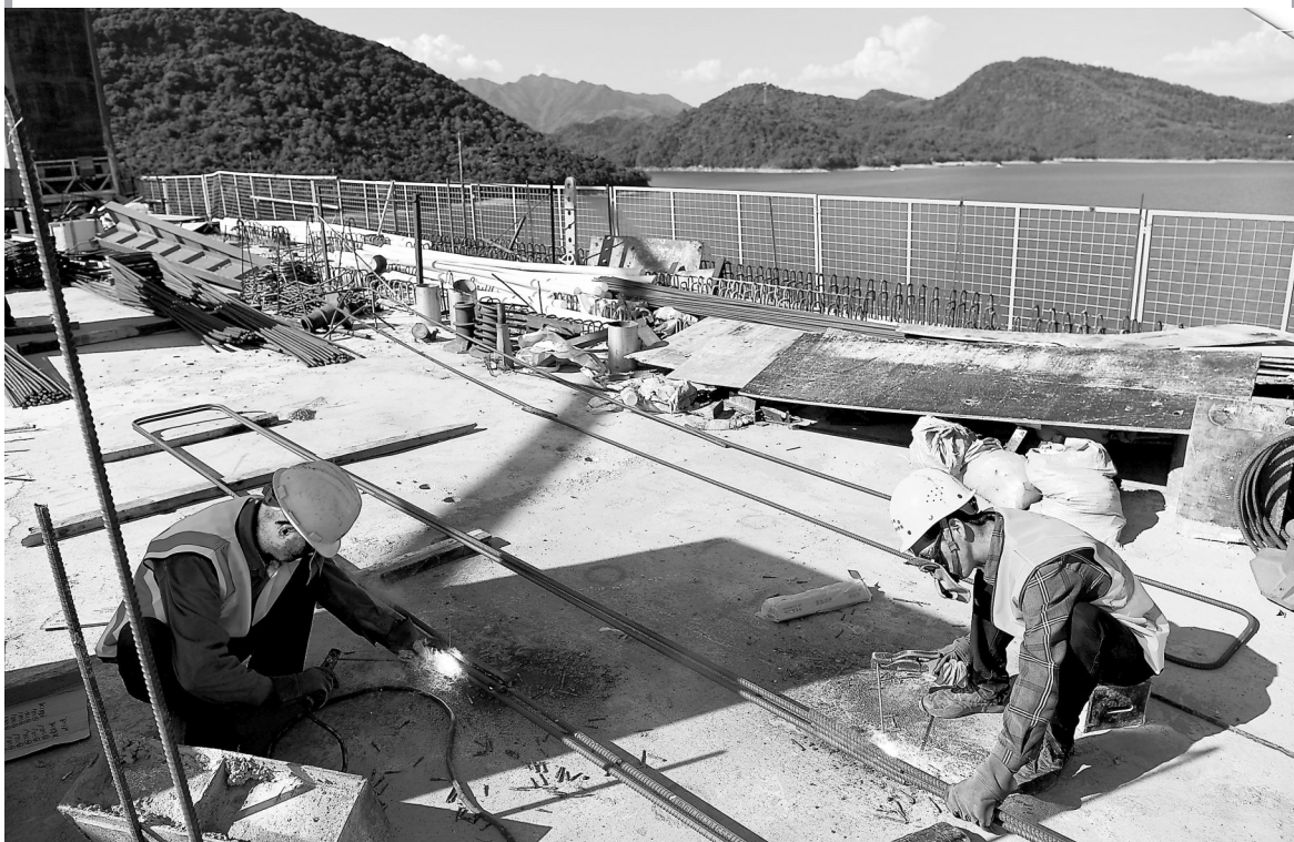
▲8月12日,工人在中国铁建大桥局池黄铁路太平湖特大桥建设工地施工。
