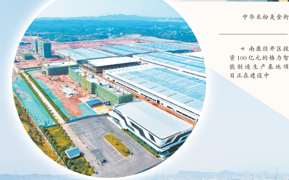
向康经开区投资100亿元的格力智能制造生产基地项目正在建设中
