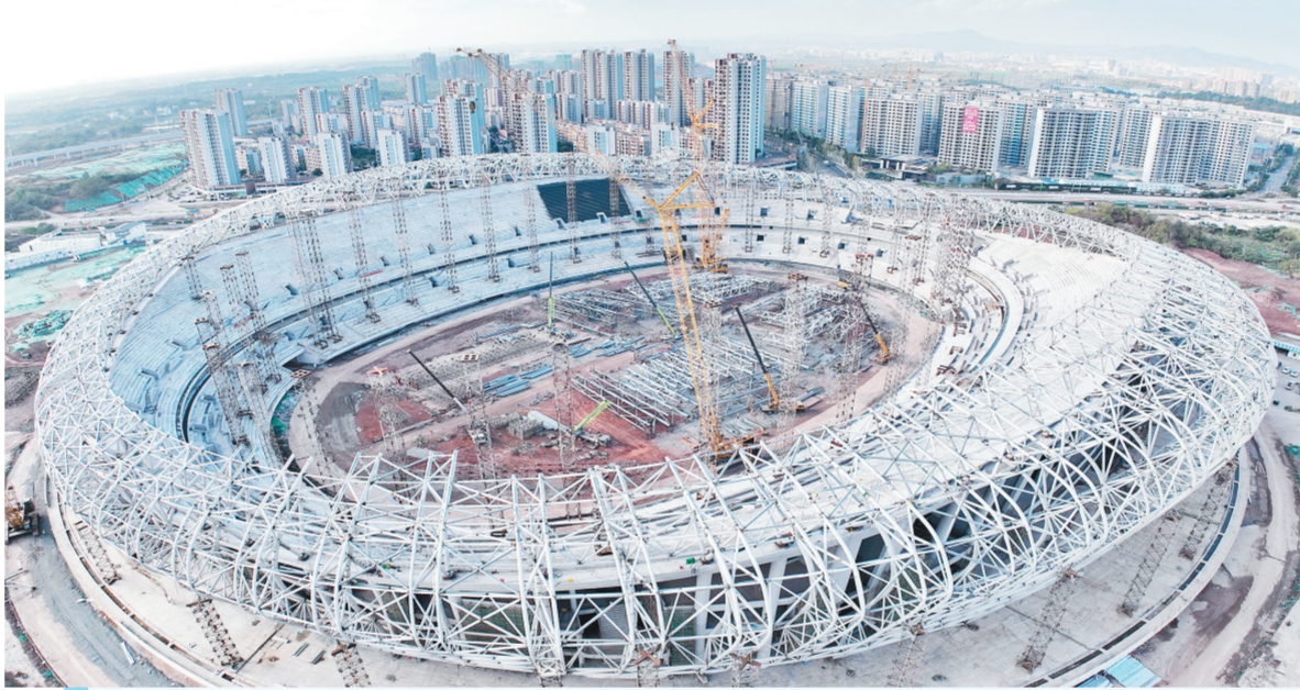
在赣州市全民健身中心一期项目建设现场，赣州城投集团组织的320余名参建人员坚守在一线，全力推进综合体育场钢结构吊装等工程施工，确保高质量完成项目节点目标。截至11月14日，该项目综合体育场钢结构吊装完成约61%，室外训练场主体结构混凝土结构浇筑完成约88%。 钟万汕摄
