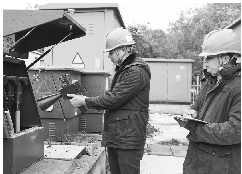
受强寒潮影响，12月1日，南昌最低气温降至0℃，全市用电负荷不断增加。为保障低温天气下安全可靠供电，国网南昌供电公司朝阳供电中心电力工人对电缆分支箱进行局部放电检测，确保设备正常运行。 本报全媒体记者 杨莹摄
