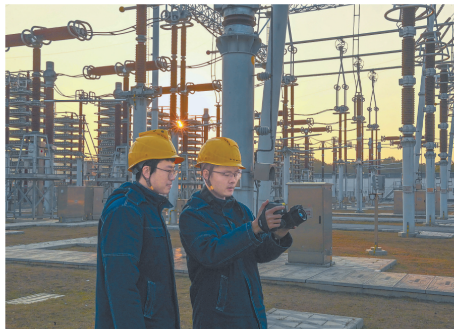
1月21日,抚州市东乡区特高压鄱阳湖换流站运行值班员正在交流滤波器场开展设备巡视监测。雅中-江西特高压直流工程是我省第一条特高压直流输电工程,途经四川、云南、贵州、湖南和江西5省,线路全长1696公里。 本报全媒体记者 李劭摄
