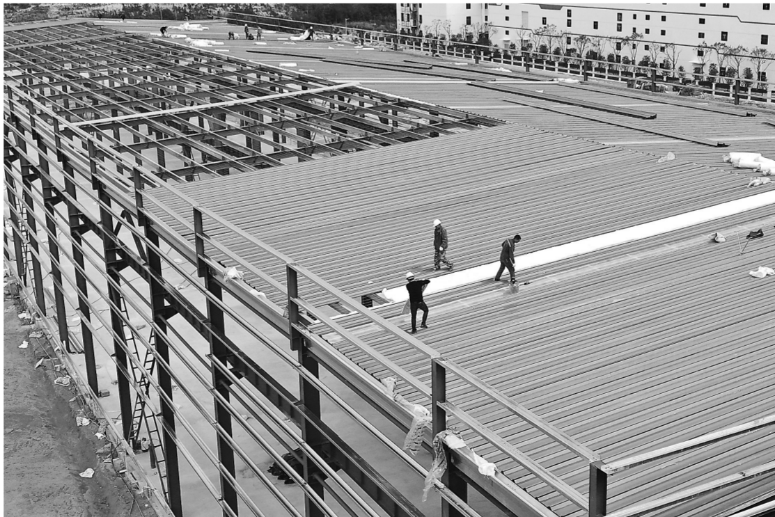
1月31日,定南县赣州龙凯科技有限公司年处理8万吨废旧锂电池梯次再生利用项目建设工地,工人正在铺设厂房顶棚玻璃棉。该项目总投资20亿元,预计3月可竣工投产。特约通讯员 詹继成摄
