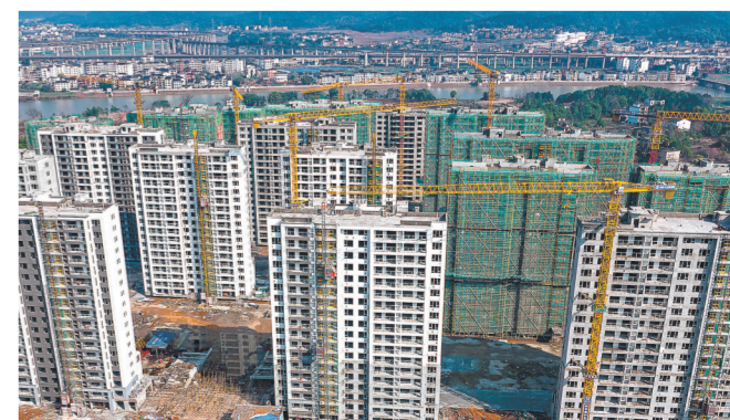
2月16日,记者航拍上饶市信州区上饶安置房灵湖安置小区项目,建设现场塔吊林立,中铁十五局的工人们正在抓紧施工。据了解,灵湖安置小区建成后能安置居民1351户,目前正在加快施工进度,在保质保量前提下完成6月交付计划。 本报全媒体记者 吕玉玺 摄
