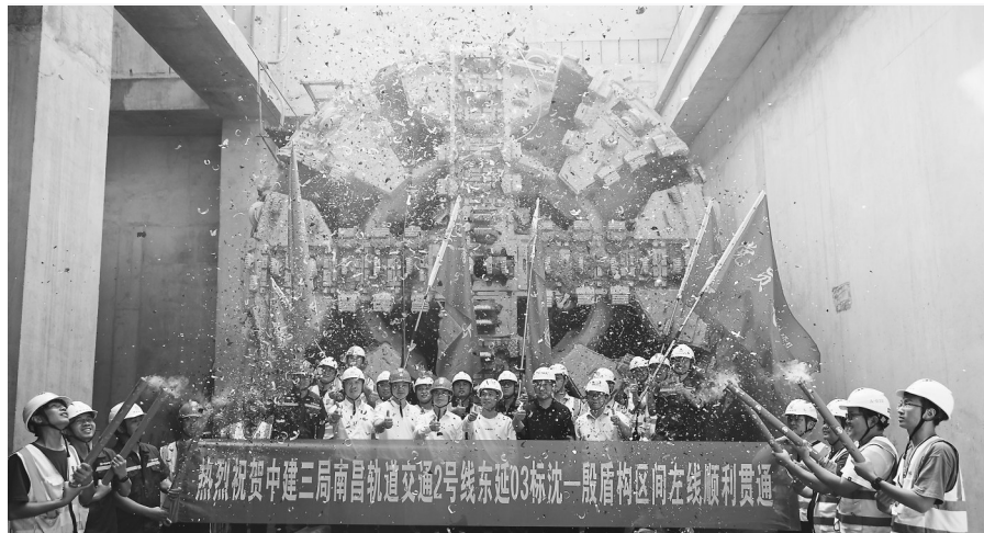
5月26日，随着“洪都争先锋”盾构机缓缓驶出，南昌地铁2号线东延工程沈桥站一股王站盾构区间左线顺利贯通。该工程是南昌市轨道交通线网中重要的骨干线路，建成通车后将串联起南昌西站、南昌火车站和南昌东站三大综合交通枢纽。本报全媒体记者 洪子波摄
