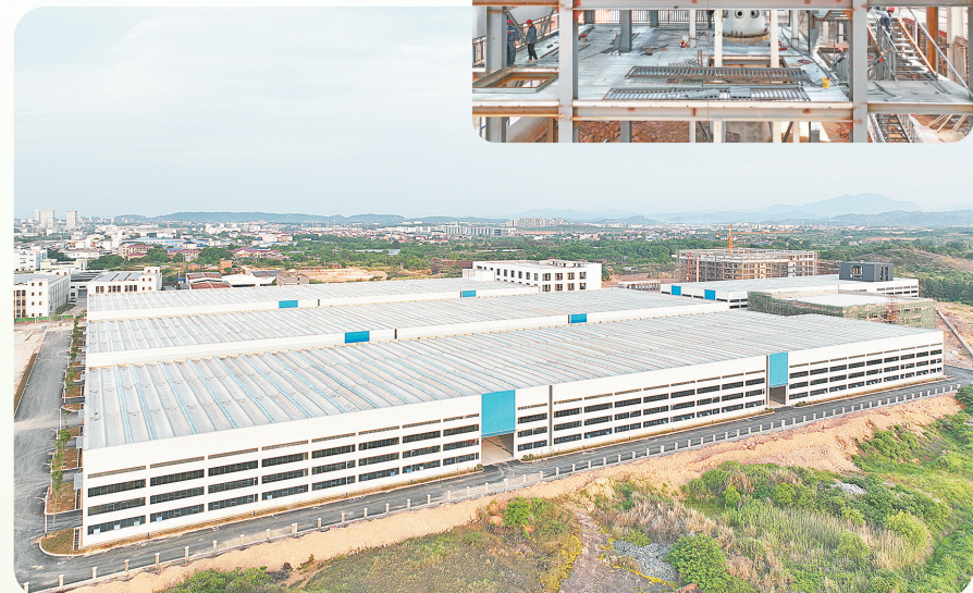
中辰电缆14万平方米厂房已经建成，正在进行设备安装，预计6月底可实现投产
