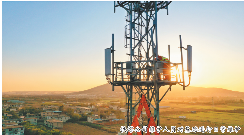
铁塔公司维护人员对基站进行日常维护
