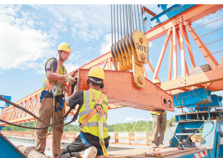
6月27日，由中国十九冶集团有限公司承建的上浦高速项目管家1号桥正在加紧施工。上浦高速是上饶市乃至江西省通往东南沿海城市的快速通道，对我省经济发展意义重大。 本报全媒体记者 吴福清摄
