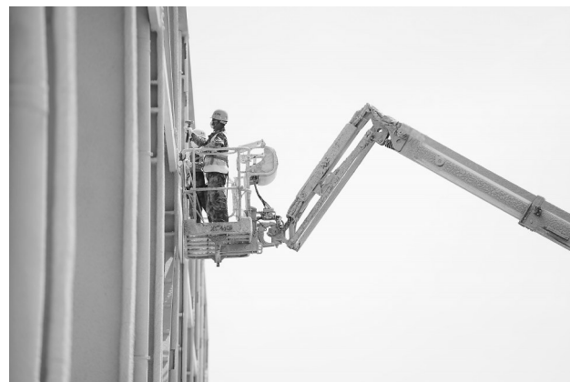
7月13日,位于新余经开区的精品钢产业园项目施工现场,工人们正加紧施工进度。项目指挥部合理安排施工时间,保障工人施工安全,确保项目顺利推进。
