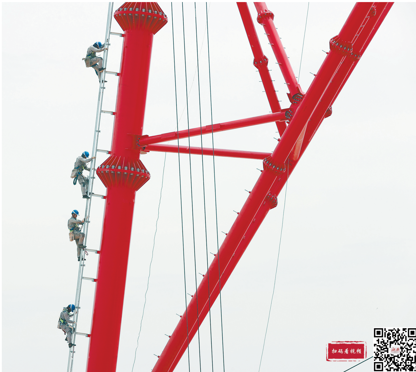
7月7日，施工人员在做好安全防护的前提下，爬上一百余米高的塔身组立跨江输电钢管塔。
