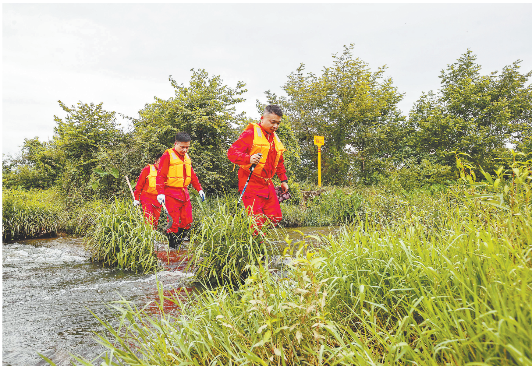
7月7日，永修县滩溪镇下湾村，廖涛（右）和巡线队队员蹚过小溪，准备对这里的燃气管道进行监测。
