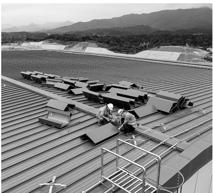
10月4日,昌景黄高铁乐平北站站房建设进入尾声,工人正在进行收边收口工作。 本报全媒体记者 吴福清摄
