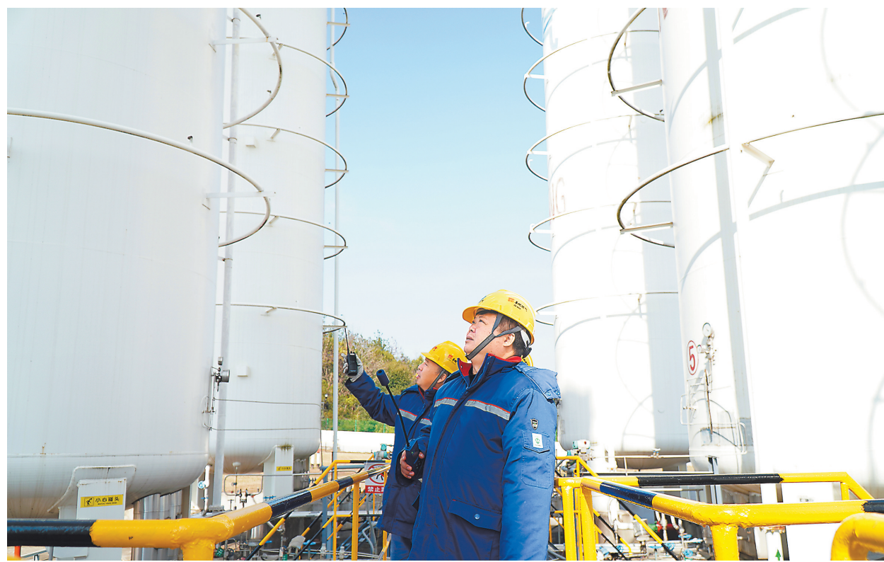
12月22日，南昌市新建区燃气有限公司的技术人员正在对管网、调压设施进行巡检。寒潮侵袭，南昌市天然气供需量急剧上升。为应对寒潮，南昌燃气集团启动冬季保供应急预案，确保天然气安全稳定供应。
