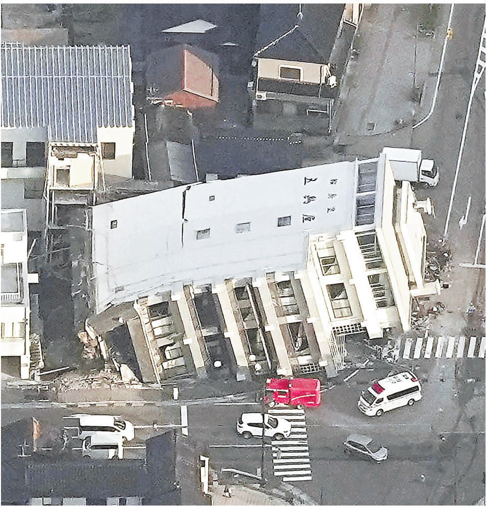
这是1月2日在日本石川县轮岛拍摄的倒塌建筑。新华社/美联
