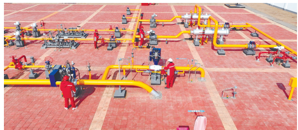
工人正在对天然气站进行日常维护。本报全媒体记者 付强摄
