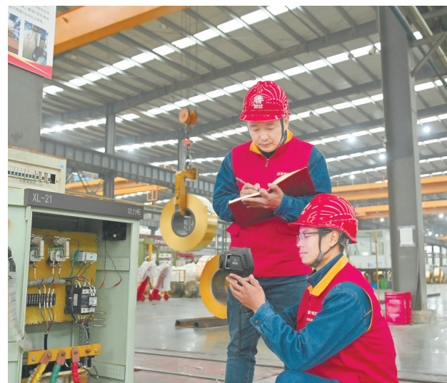
1月19日,在国家高新技术企业江西云泰铜业有限公司,国网鹰潭供电公司资溪雄石供电所工作人员正在进行红外测温 and 局部放电检测。当前,我省各地电力部门深入企业排查安全隐患,保障安全用电。 本报全媒体记者 李劫摄
