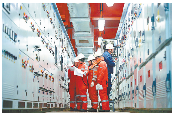
1月25日，工人在埕北油田CEPC(中心平台)检查岸电设备。新华社记者 赵子硕摄
