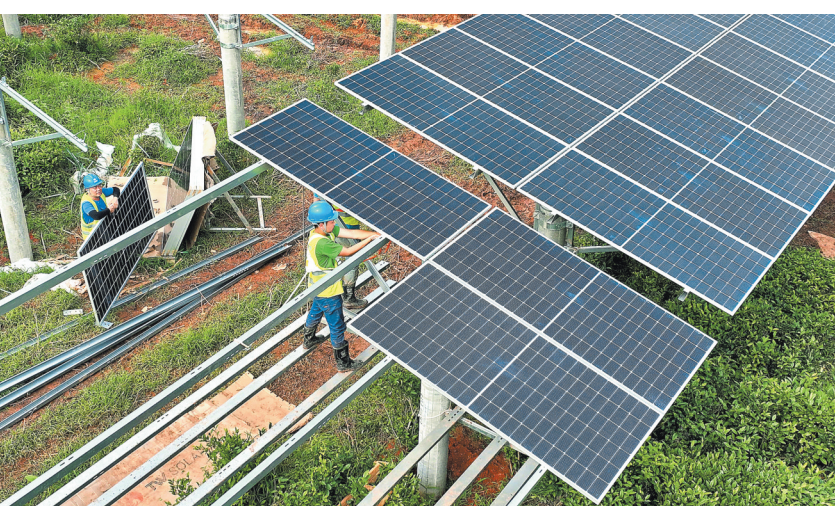
近日,在永丰县佐龙乡奇背坑村茶场,大唐永丰县恩江光伏发电项目进入光伏板安装阶段。近年来,该县因地制宜实施农光互补项目,板上发电、板下种植,产生叠加效应,赋能乡村振兴。 通讯员 刘浩军摄
