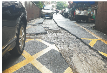
开挖后未修复的道路。本报全媒体记者 蔡颖辉摄
