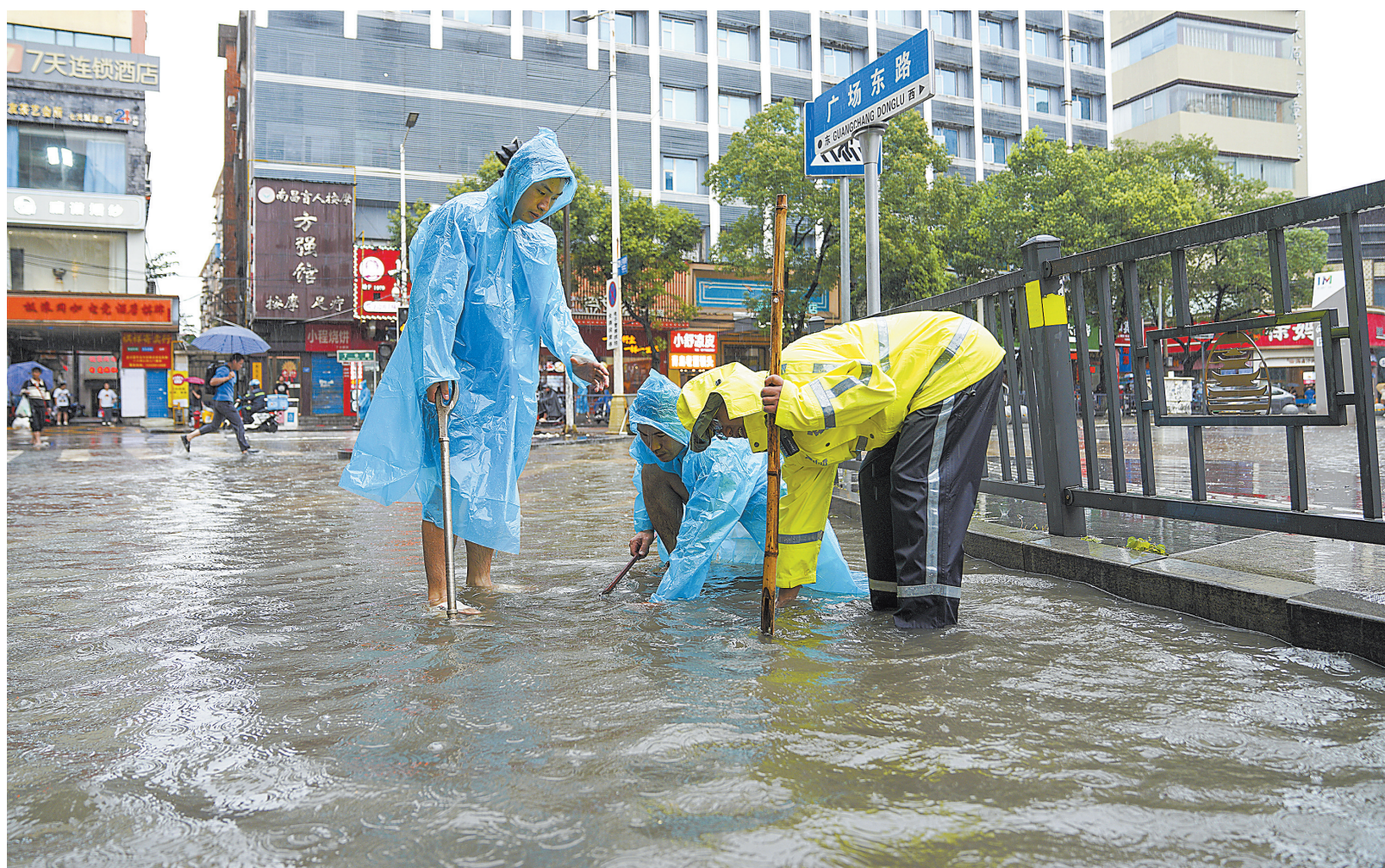
6月24日，南昌市西湖区东丁公路街道乐盈广场路口出现积水，西湖区消防救援大队洛阳路中队消防队员迅速到现场开展排涝工作，为市民出行保驾护航。本报全媒体记者 史港泽摄
