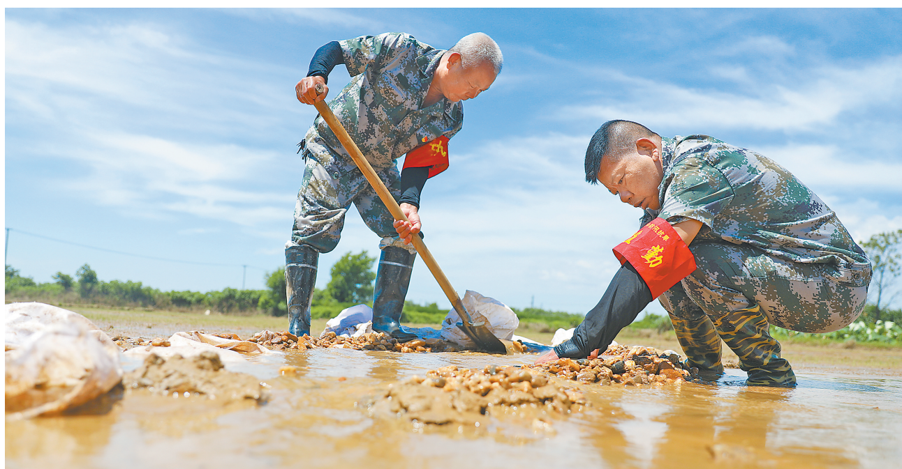
7月8日,南昌市新建区铁河乡的防汛工作人员在赣西联圩铁河方洲段,对泡泉周围的薄弱环节进行加固。
