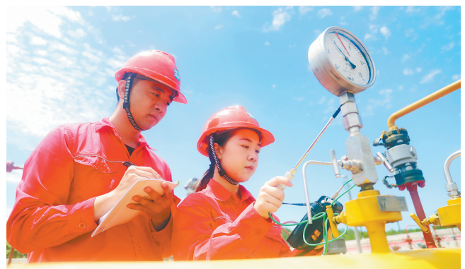
面对持续晴热高温天气，江西省天然气集团有限公司管道分公司吉安站输气工在烈日炙烤下坚守一线，用行动保障燃气安全稳定供应。图为7月16日，输气工在高温下对燃气设施进行保养维护。
