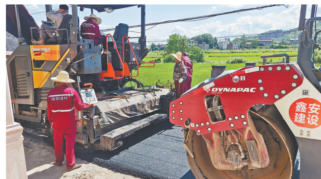
上栗县金山镇简村施家湾的道路坑坑洼洼，雨天泥泞不堪，给村民出行带来不便。日前，接到情况反映后，金山镇政府和简村两委积极协调，筹集资金和原料，对道路进行升级改造，极大地改善了群众出行条件。
