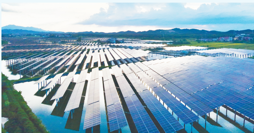
图为位于上高县的田头光伏项目基地
