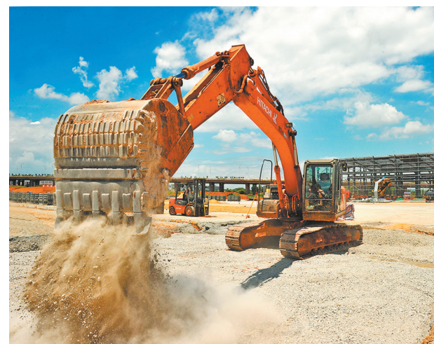
连日来,位于赣江新区临空组团的龙头岗综合码头二期项目建设现场,建设者们坚守在建设一线,确保工程建设有序推进。据了解,总投资6.27亿元的2个2000吨级泊位建成后,码头年吞吐量可提升190万吨。 本报全媒体记者 杨静摄
