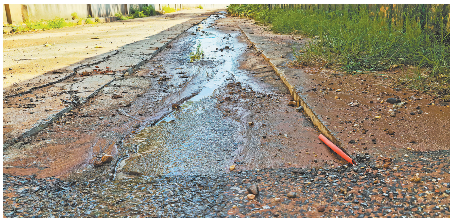
部分管网路面出现下沉开裂。
