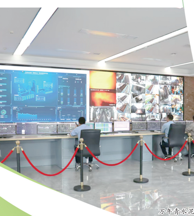
万年青水泥生产中控室
