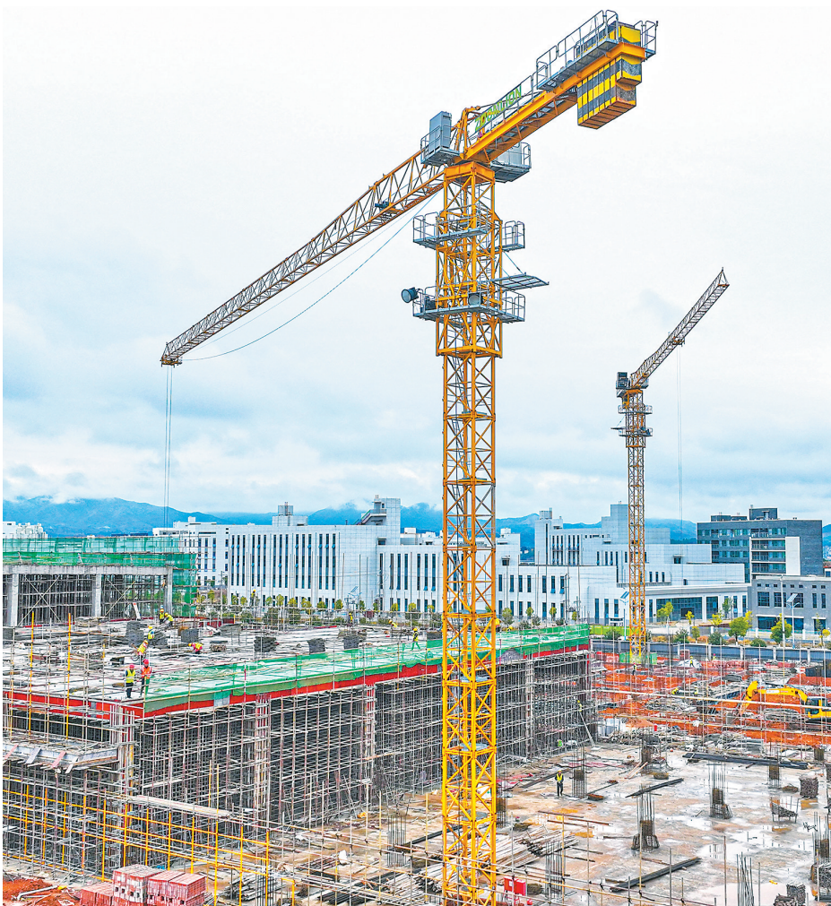
2月20日，赣州市章贡区度东稀土金属智造产业园项目建设现场，施工人员正在作业。特约通讯员 胡江涛摄
