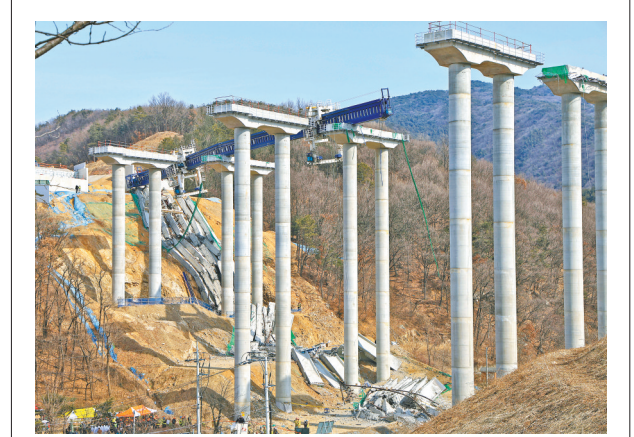
这是在建桥梁坍塌事故现场。 新华社/美联
