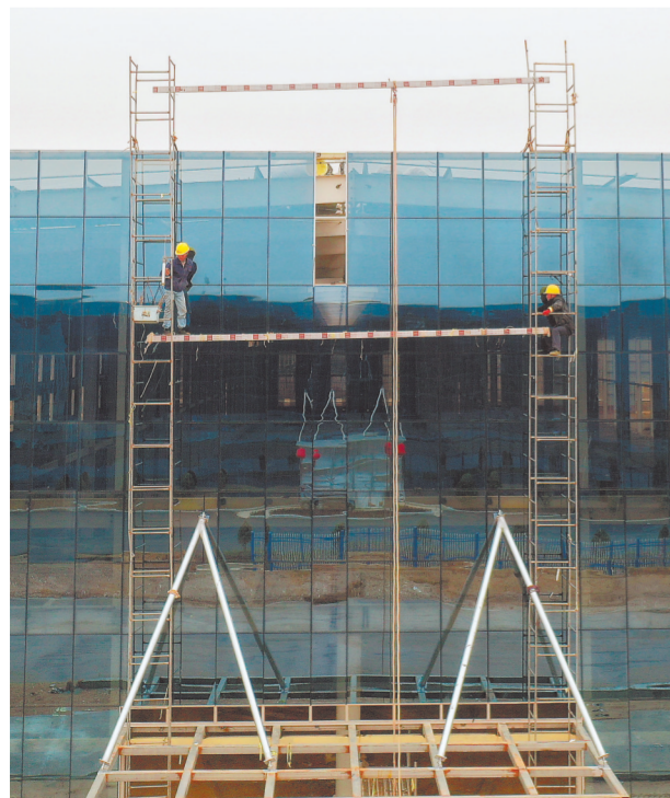
2月23日,乐平永泰智能产业运营有限公司项目施工现场,施工人员正铆足干劲抢抓时间,大力推进项目建设。王蕴蓉摄
