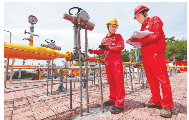
7月7日，在江西省天然气有限公司九江管理处永修分输站，工作人员正对设备进行安全检查。高温持续，天然气供应管理部门加强管网周边巡线监测，对运行管网、附属设备实施“体检”，保障安全供应。 本报全媒体记者 徐铮摄
