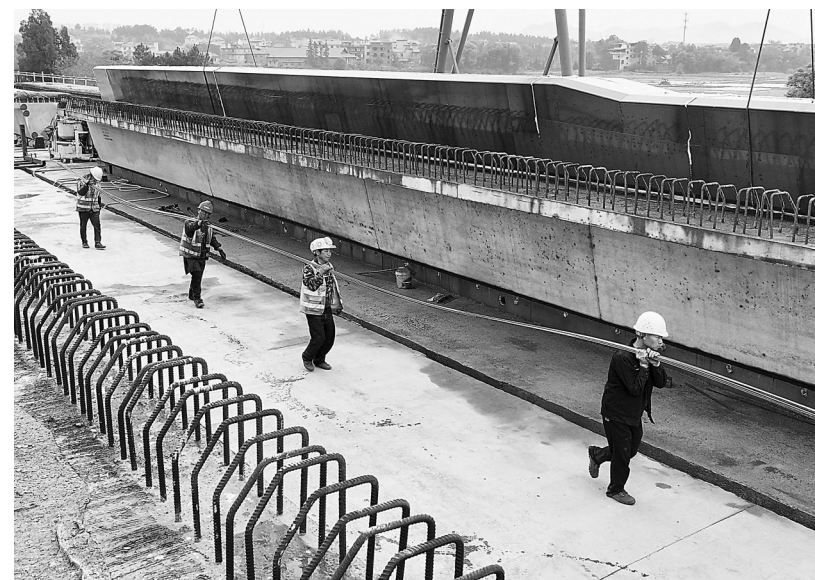
近年来,永丰县持续致力于打通“断头路”、拓宽“瓶颈路”,赋能当地经济社会高质量发展。图为4月4日,永丰县绕城公路项目建设现场,工人正在加紧公路桥梁施工作业。通讯员 刘浩军摄
