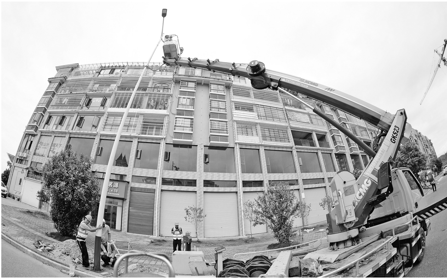
今年以来，会昌县在城郊、背街小巷等安装了800余盏路灯，进一步改善群众生活环境。图为5月16日，会昌县文武坝镇羊角堡路，施工人员正在安装路灯，保障居民出行安全。 通讯员 吕春华摄
