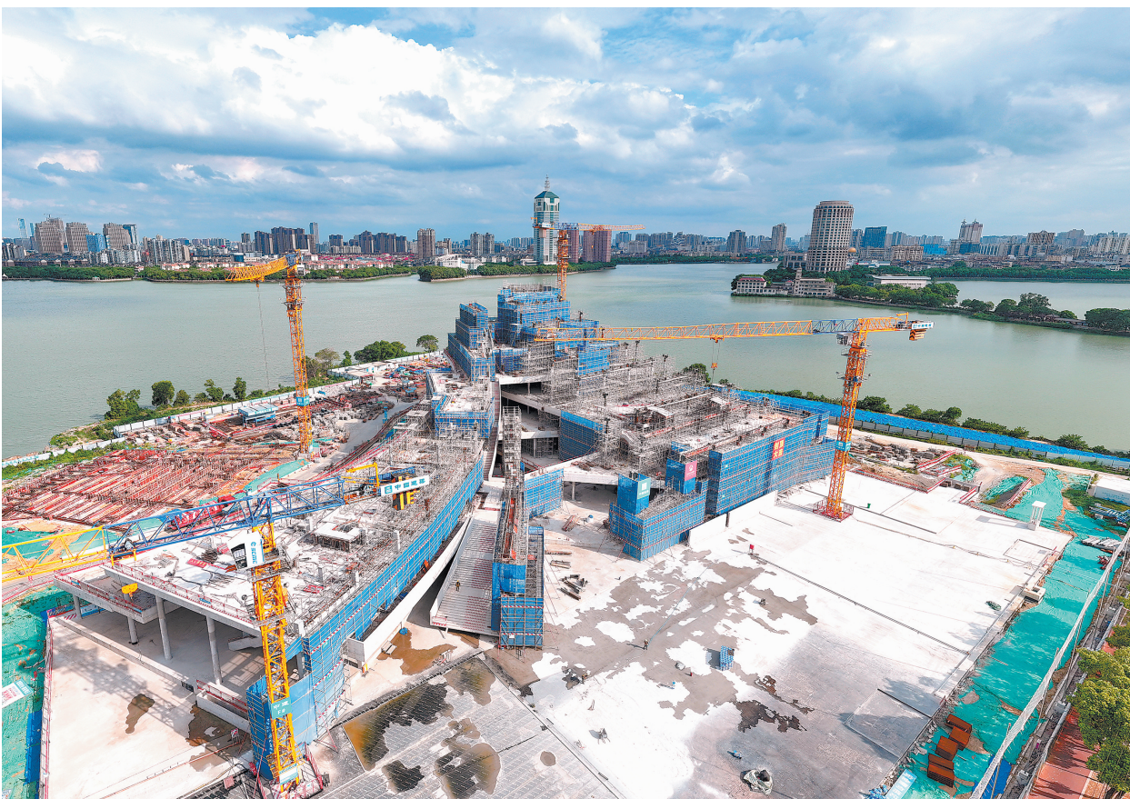
南昌市图书馆新馆项目是南昌市重点工程,目前进入二次结构砌筑、钢结构安装等施工,建成后,阅览座位数量可达2000个,总藏书量可达300万册。图为8月7日,南昌市图书馆新馆项目建设现场。 本报全媒体记者 王蕴蓉摄
