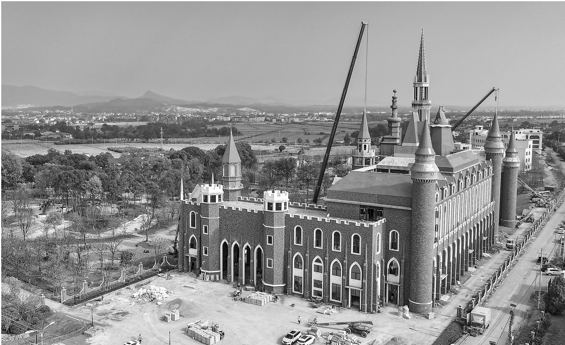
靖安县香泉农文旅项目总投资10亿元，涵盖住宿、研学等文旅多种业态，目前主体结构已完工，预计年底开园。图为10月28日，工人正在粉刷墙体。
