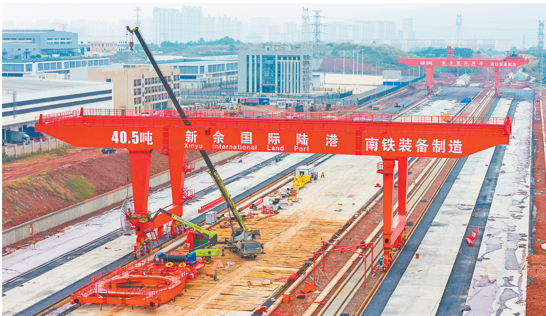
11月6日，新余国际陆港铁路专用线项目建设现场，工人正有序施工。该铁路专用线建成后，将极大提升赣西地区物流集散能力，降低企业运输成本，促进当地经济发展。
