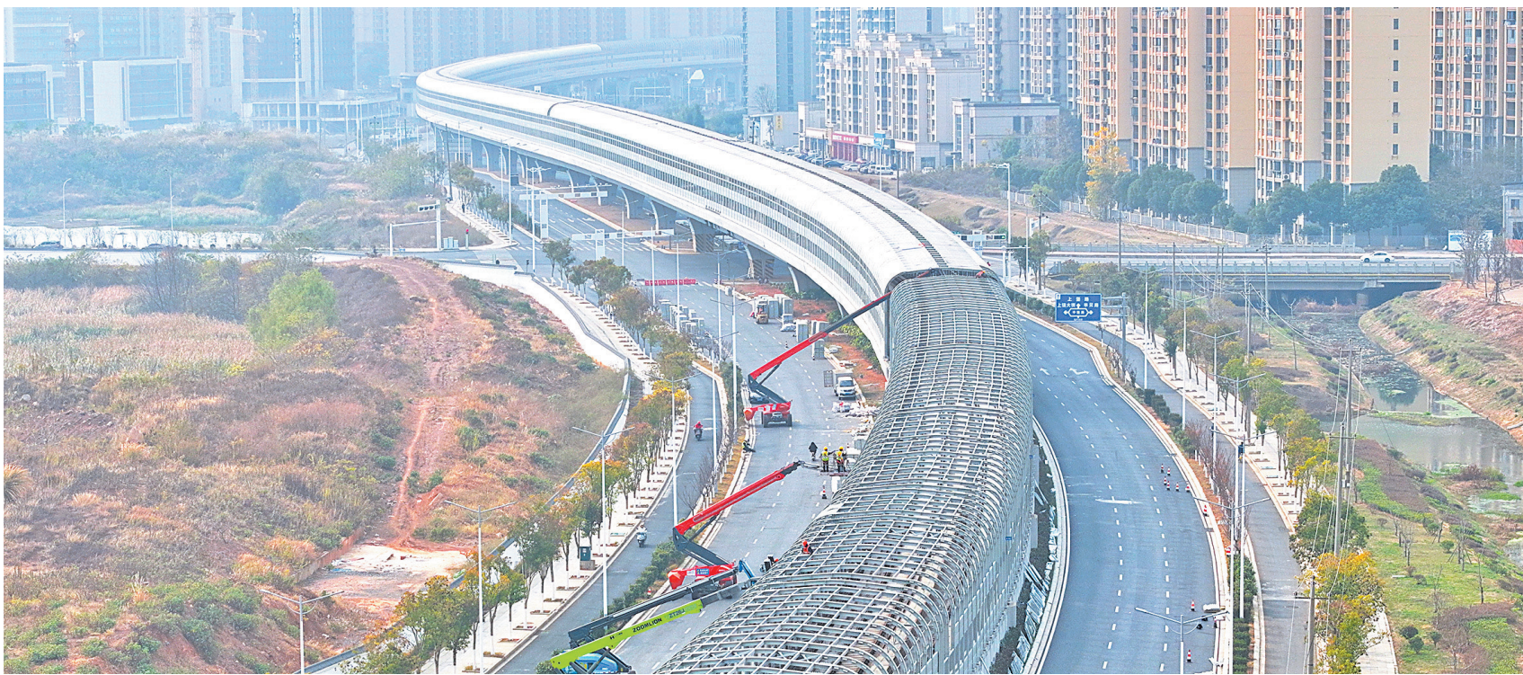
为解决噪声对沿线居民的困扰，南昌轨道交通4号线一期工程高架段正在增设声屏障，预计这项工程12月31日完工。图为12月12日，工人抓紧全封闭式声屏障加装施工。
