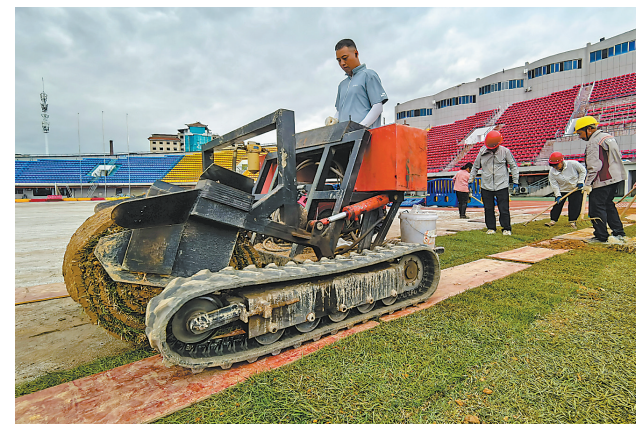
4月10日，宜春体育中心足球场，工人正在铺草皮。该足球场是2026年赣超宜春赛区主场，目前正全力推进场地改造，预计4月底竣工。 本报全媒体记者 邹海斌摄
