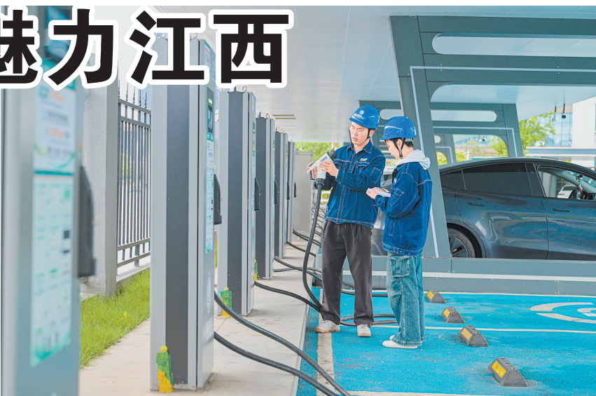
4月29日，南昌市红谷滩区九龙湖供电所工作人员对辖区充电桩设备展开专项检查，全力保障“五一”假期新能源车充电需求。 本报全媒体记者 张翰林摄
