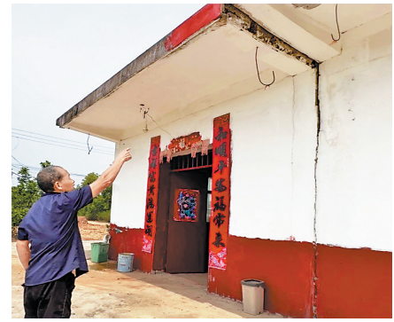
村民指着房屋裂缝。
