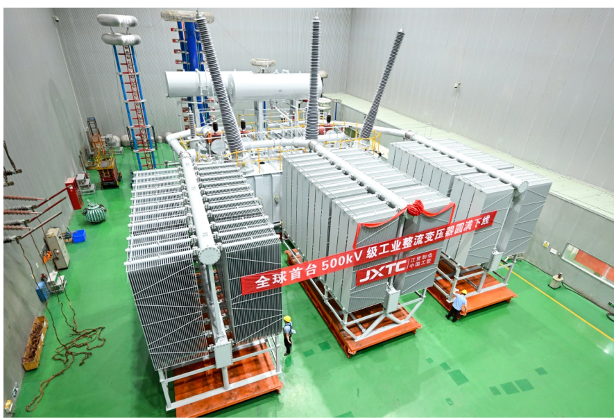
由江西变压器科技股份有限公司自主研发、制造的全球首台500kV级工业整流变压器顺利完成全套出厂试验，圆满下线。 本报全媒体记者 洪子波摄
