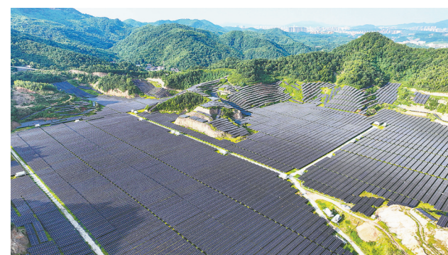
6月15日,航拍视角下,萍乡市湘东区湘东镇千亩光伏板连片成景。这片昔日废弃用地,通过“光伏+生态修复”模式改造成光伏电站,年发电量可达2500万千瓦时。
