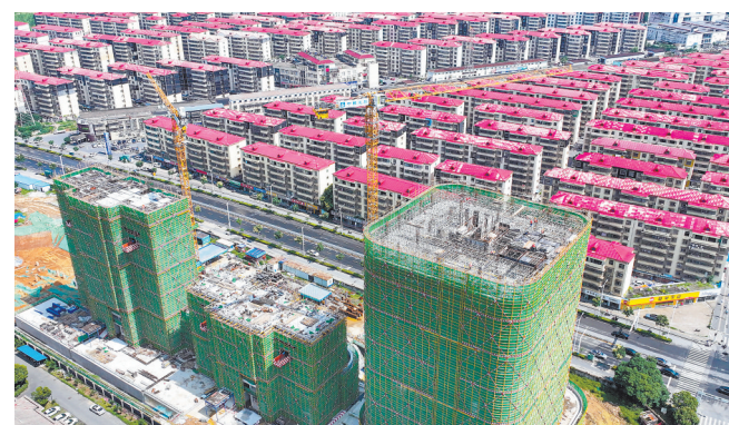
6月22日，南昌高新区艾溪湖南住宅小区五期A区工程正在有序建设中。该项目总建筑面积约14.75万平方米，建成后可提供780余套安置房，进一步提升城市人居环境。 本报全媒体记者 张翰林摄
