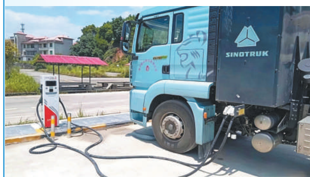
铁塔新能源基站新能源大卡有序充电（图片由中国铁塔江西省分公司提供）
